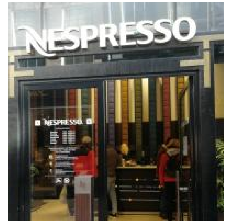
ПЛОХО. Вывеска без подложки не привязана к структуре здания, расположена на стыке остекления и простенка
